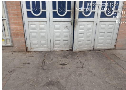
Foto No.5. Ubicación Caja de Inspección Externa
